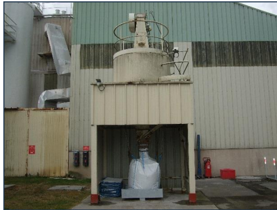
En bas à droite: Zone d'ensachage des cendres volantes après acheminement par le couloir vibrant
