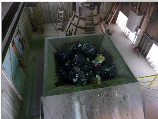
A gauche: Vue de la trémie d'alimentation et du grappin de chargement depuis l'accès au « passage chaudière »
