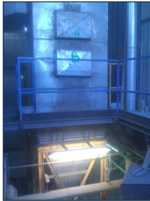
A gauche: Vue de la partie haute du multi-cyclone
